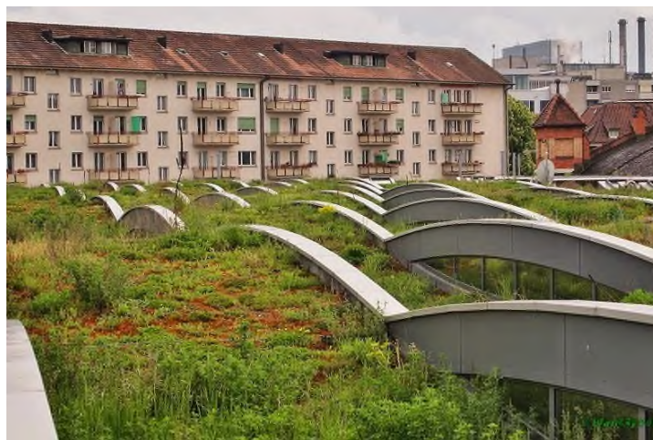
Figuur 280: Groen dak van de tramstelplaats van de stad Basel (lichtgewicht constructie met een drainagelaag van 10 cm miscanthusstro): ( http://naturetoit.blogspot.com/2014/07/le-wiesenteppich-de-bale.html )
