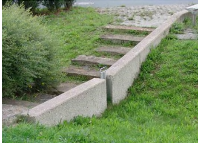
Hellende infiltratiegracht met "versterking" op het lage punt (wijk van Kronsburg, Hannover - Valérie Mahaut)
